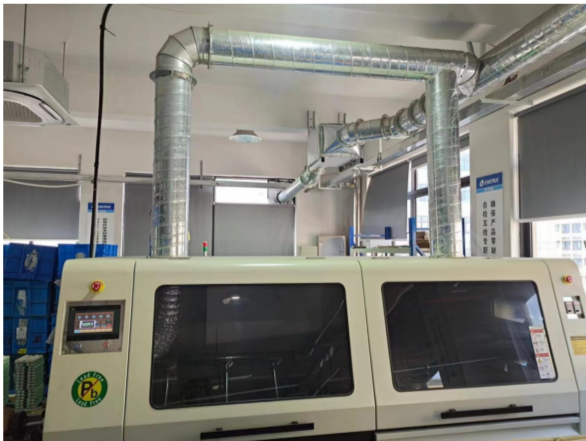
波峰焊车间集气照片
